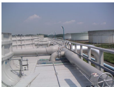
塔上送水配管
