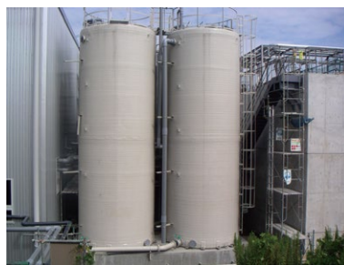
純水槽（FRPタンク）
