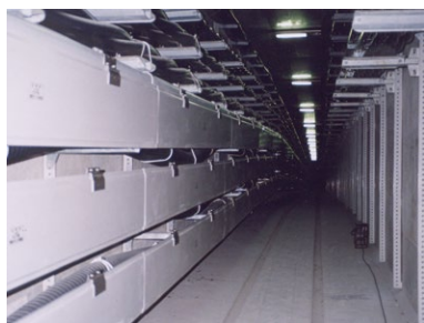
電力ケーブル防護板
